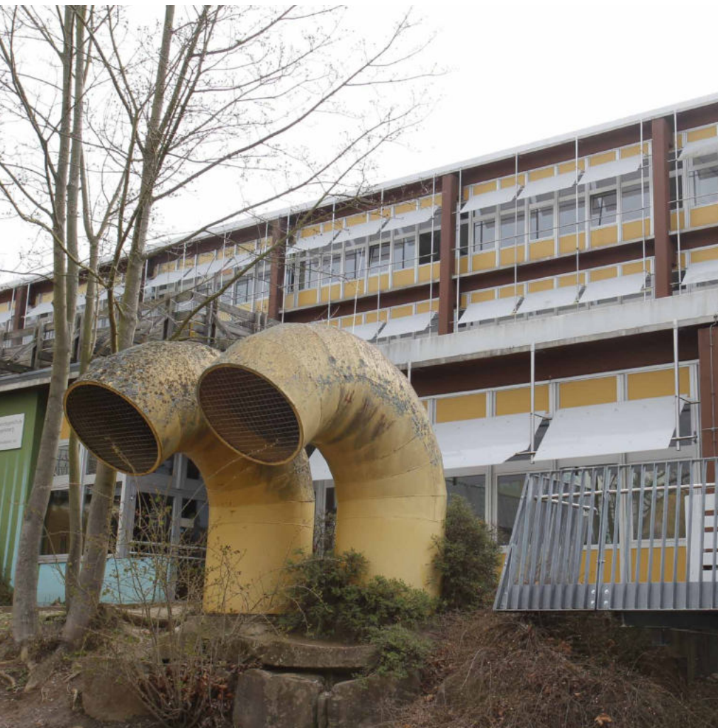
Marode Gebäudesubstanz: Die Hegelsbergschule muss dringend saniert werden.
